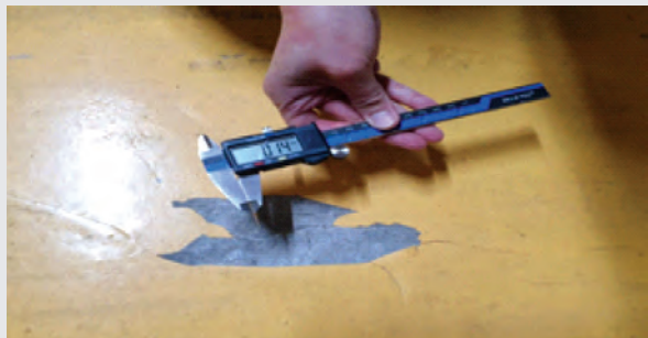
지하주차장 / 도장두께 부족시공
