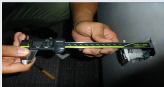
벽체 내부 / 보호몰탈 두께 부족시공
