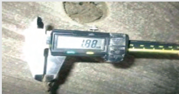
현관 방수두께 및 방수몰탈 부족시공
